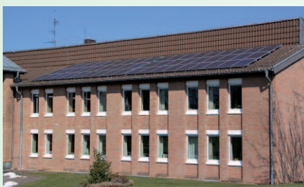
PV-Anlage auf dem Dach des Rathauses
